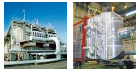
LNG気化装置
