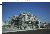
オープンラック式LNG気化器
