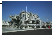
オープンラック式LNG気化器
